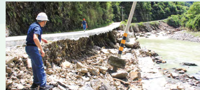
青龙水电站进坝公路冲毁
