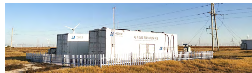
风电动态电解制氢示范工程
